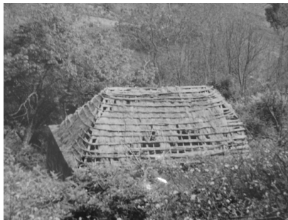
15 - Casa elementar com cobertura degradada - espólio da junta de freguesia do Jardim da Serra
