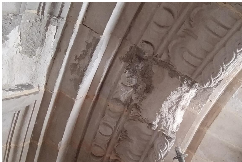
Figura 35– Vista de parte de nervadura de piedra caliza de la fábrica de la bóveda con falta acusada de material por desprendimiento. Fotografía del autor.
