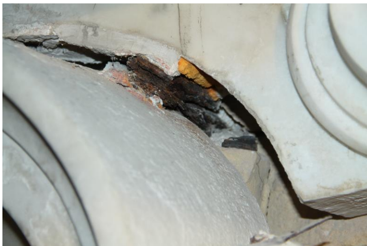
Figura 18 – Vista de pletina de anclaje afectada de exfoliación y aumento de volumen con desplazamiento de piezas de mármol del ático del retablo. Fotografía del autor antes de la restauración.
