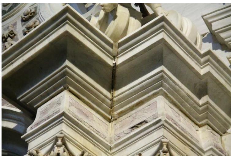
Figura 19 – Vista de la cornisa del retablo sobre los capiteles de las columnas salomónicas. Se observa la apertura de la junta estructural entre piezas por desplazamiento de las mismas así como desprendimiento de incrustaciones. Fotografía del autor antes de la restauración.
