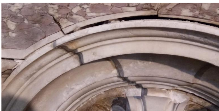
Figura 17 – Vista del empuje y fractura de una de las piezas sobre el arco de la hornacina central producido por la oxidación del anclaje. Fotografía del autor antes de la restauración.
