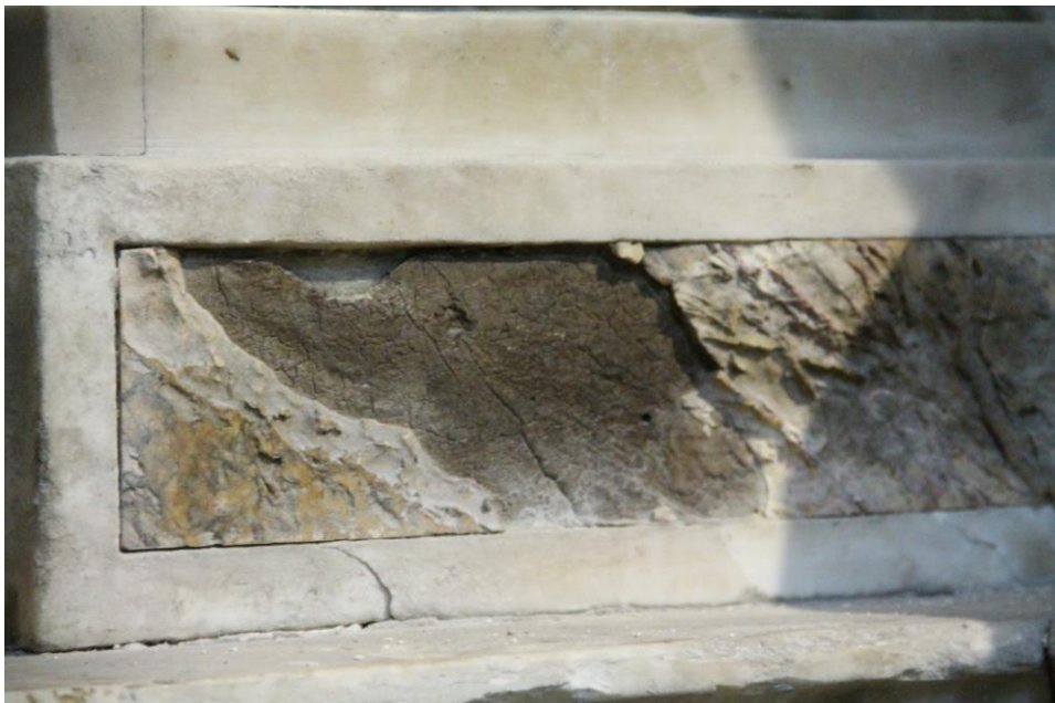
Figura 33– Vista de pérdida volumétrica en incrustación de piedra por desprendimiento. Fotografía del autor antes de la restauración.
