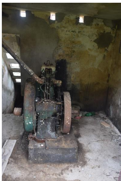
Figura 10 – Motor a gasóleo no conjunto 3; elaborado pela autora.
