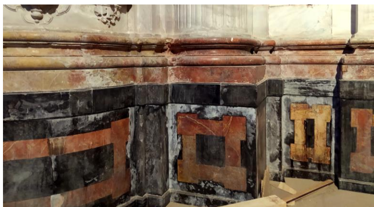
Figura 13 – Estado del zócalo de mármol policromo. Fotografía del autor antes de la restauración.
