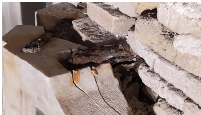
Figura 25 – Vista de anclaje original alterado. Fotografía del autor durante la restauración.
