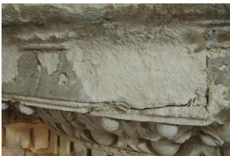
Figura 12 – Pérdida volumétrica bajo el vuelo de la cornisa. Fotografía del autor antes de la restauración.
