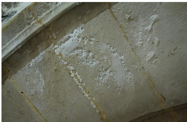
Figura 11 – Eflorescencias de sales sobre sillares de piedra caliza y morteros de rejuntado. Fotografía del autor antes de la restauración.
