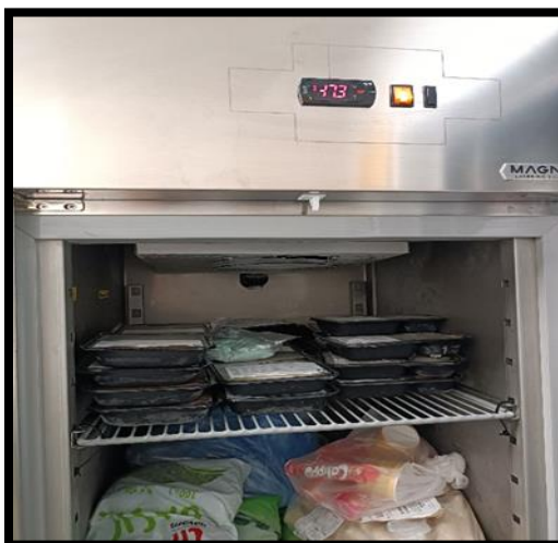
Figura 3.2.2: Interior de frigorífico de acondicionamento de refeições halal da E.B. Casal
