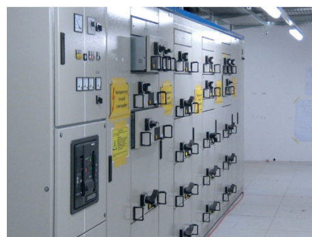
104. Dispositivo de manobra da rede elétrica no interior da Austrian Power Grid, Sprecher Automation.
