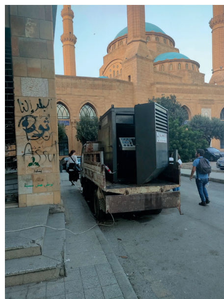
66. Gerador privado de eletricidade no centro de Beirute, Luísa Sarmento, 2021.
