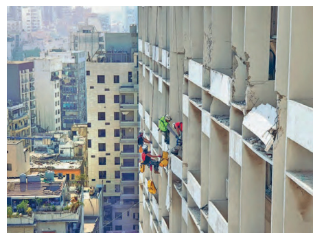
74. A fachada do edifício destruída.
