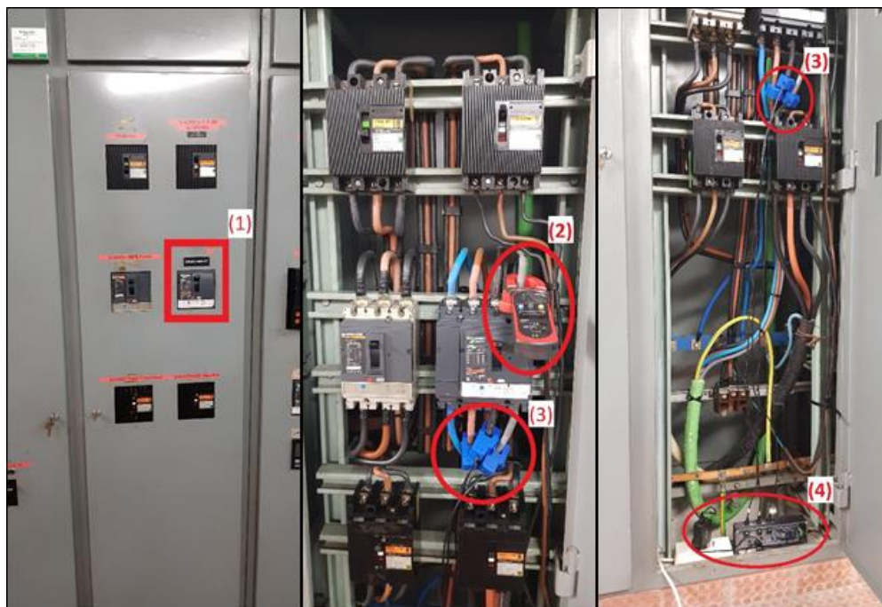
Figura 28 - Implantação dos sensores de monitorização do AVAC do Edifício 1.
