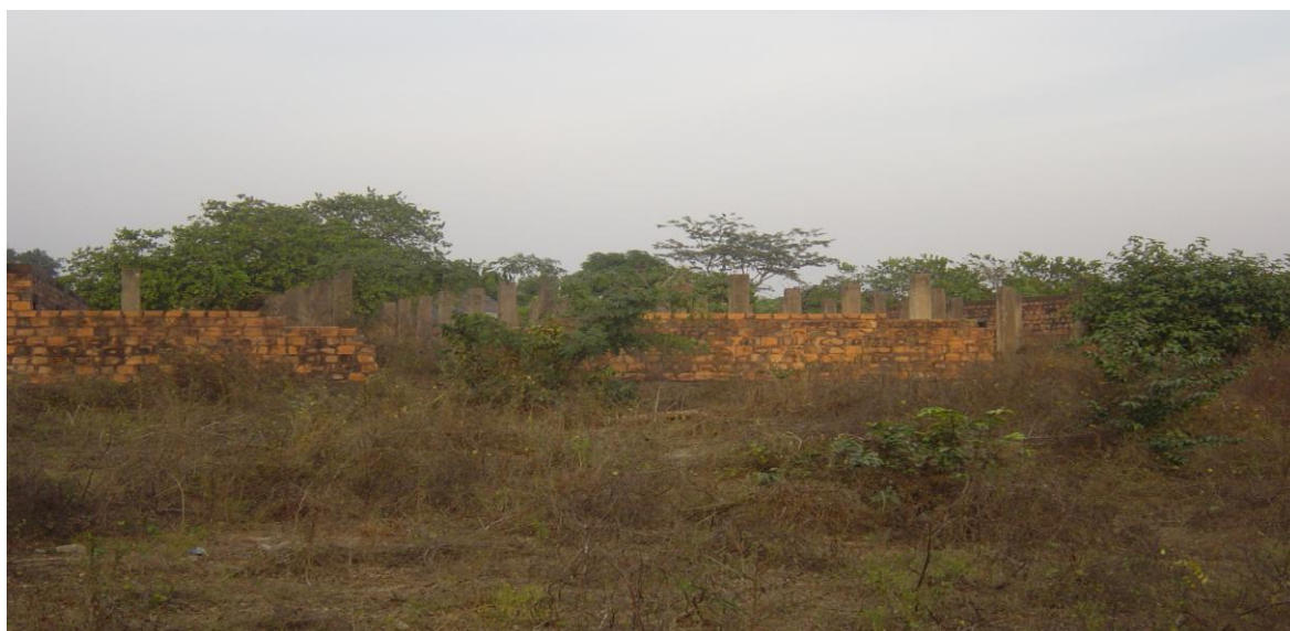
Foto 4. Espaço para o mercado de Quebo (trabalhos iniciados e abandonados em 1986)
