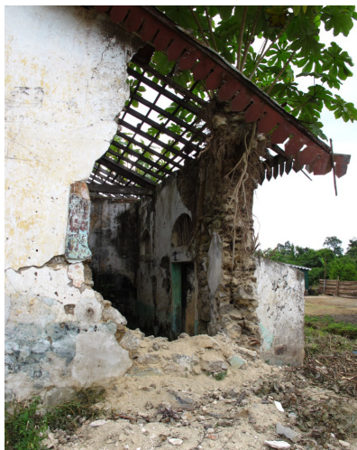
Figura 18 - Estado de avançada degradação, Armazém, Roça Boa Entrada, São Tomé [HMS, 2011].
