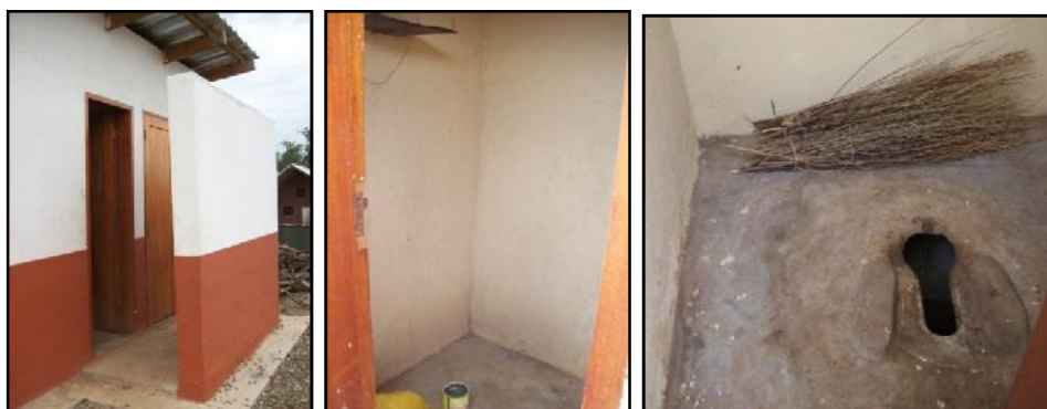
Figura 4.2.2 – Edificação sanitária (vista exterior; vista interior da casa de banho; vista interior da latrina) (Joana Pedro, Junho 2011)
