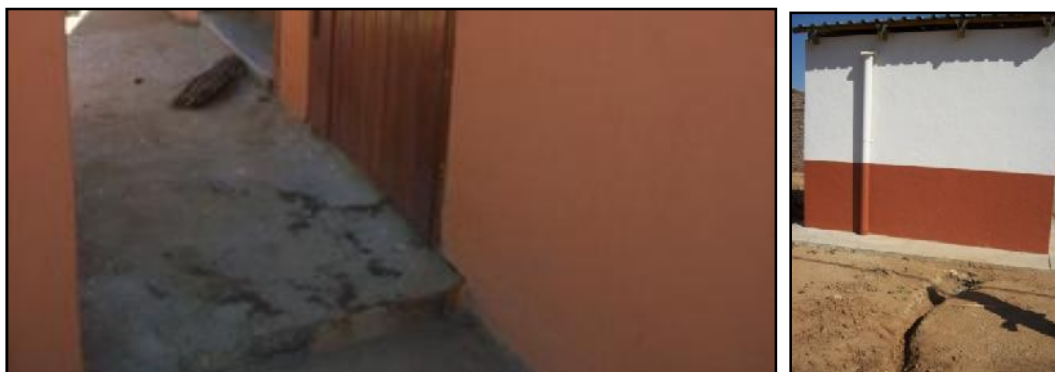
Figura 4.2.3 - Indícios de problemas na latrina (vestígios de inundação no chão e exemplo de local onde tiveram de escavar um dreno do tubo da casa de banho para que água conseguisse escoar – neste caso, para a via pública) (Joana Pedro, Junho 2011)
