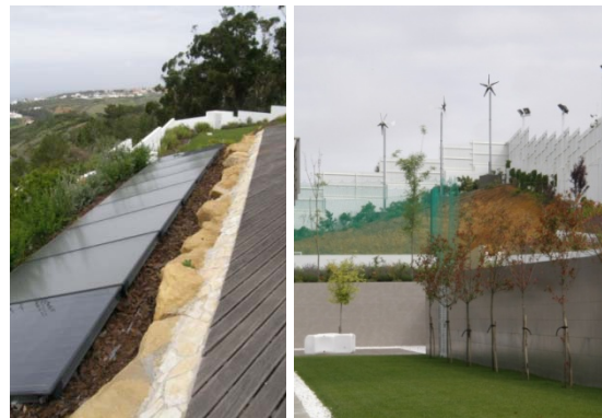
Fig. 9 e Fig. 10– Painéis solares para aquecimento das águas da piscina, spa e águas sanitárias domésticas; pré-instalação de painéis fotovoltaicos; moinhos eólicos para a energia utilizada no interior da habitação. No exterior da habitação existe uma estação meteorológica para detectar o estado do tempo de modo a accionar, ou não, determinadas funções domésticas. A iluminação exterior é totalmente executada com base em leds e, no interior, com lâmpadas de baixo consumo e leds. Kasa do Futuro, Ericeira (SE 2009)
