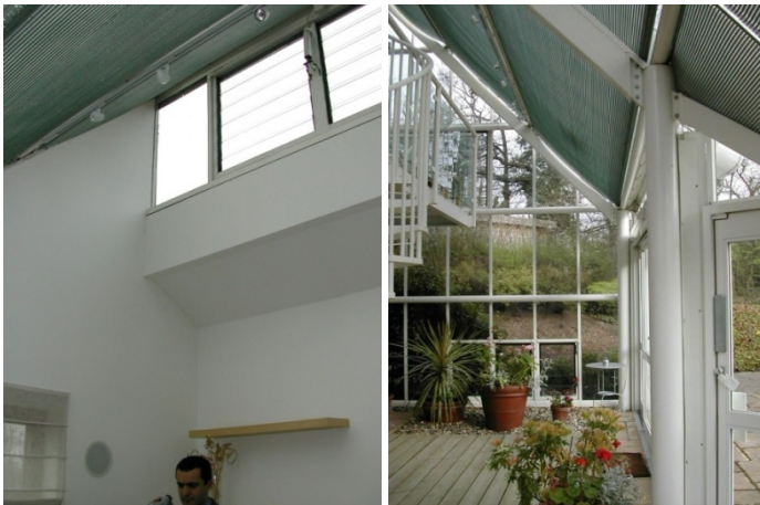
Fig. 3 e Fig. 4 – Utilização de motores para abrir e fechar janelas no invólucro exterior do edifício para garantir ventilação. Millenium House, projecto Integer, Watford (SE 2004)
