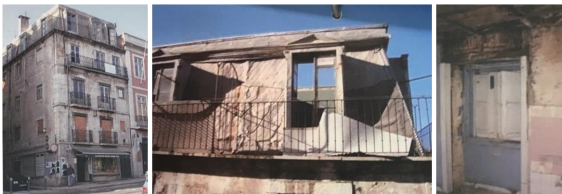
Figura 3 – Registos fotográficos do estado de conservação do imóvel antes da intervenção, Processo n.º 987-DMGU-EDI-2005
