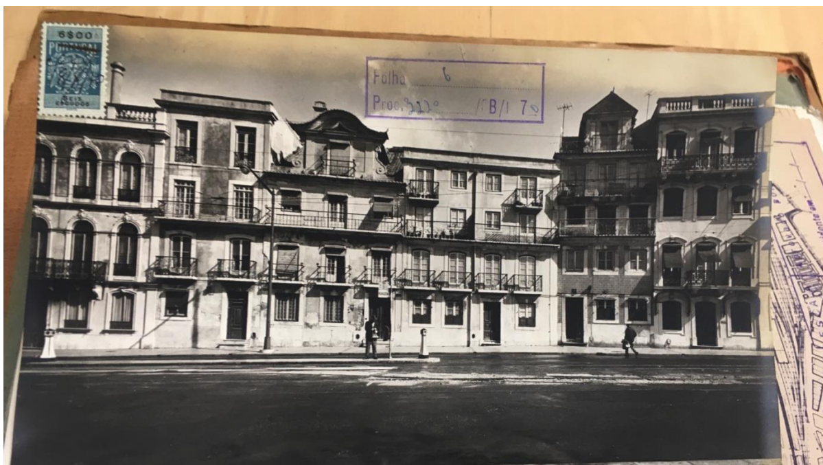
Figura 5 - Sinais de degradação presentes desde a década de 70. Consultado no Arquivo Municipal de Lisboa, Processo de Obra n.º 20724, Processo 2/20/B/1970.
