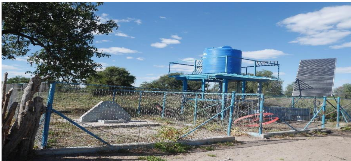
Figura 4.1 – Sistema de água com recurso a energia solar em Ondova
