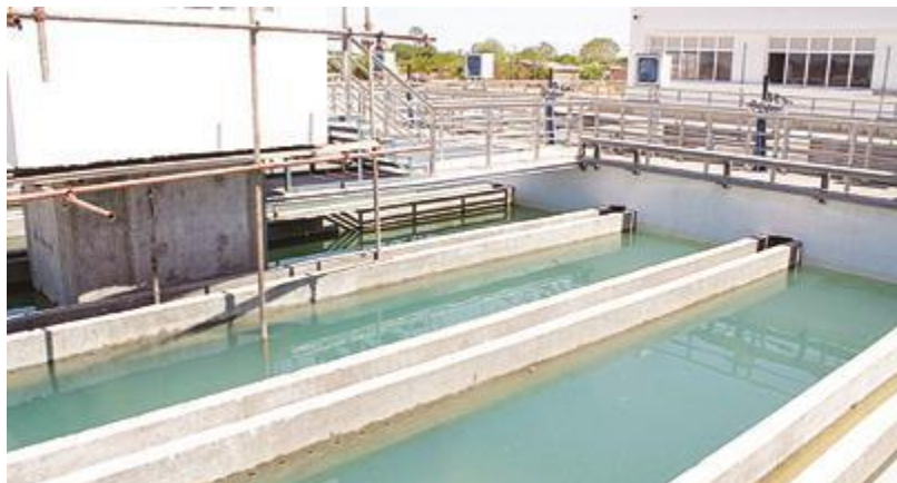
Figura 4.6 – Tratamento de água do rio Cunene em Xangongo/ Cunene
