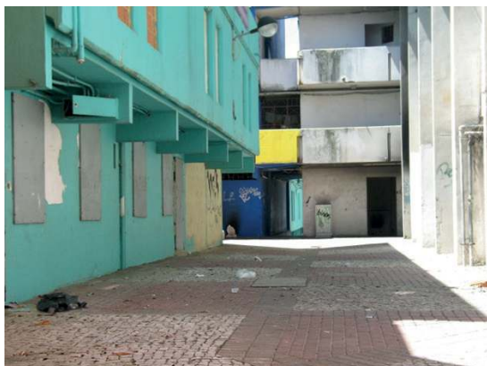
Figura 3 ▶ Piso térreo para o corredor central. Bairro do Condado, Zona J, Marvila, Lisboa
